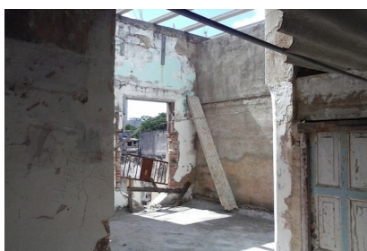
El cuarto deshabitado que iban a reparar y dejaron así
