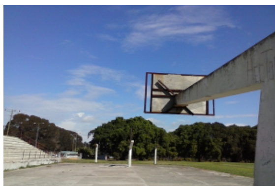
Cancha de básquet deteriorada en el centro José Martí_ foto Ernesto García
