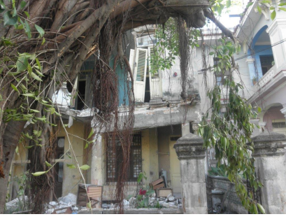
Derrumbe de inmueble en el Vedado (foto del autor)
