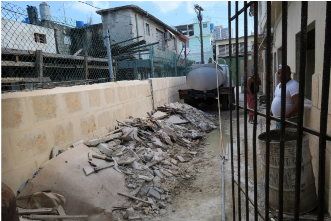
La planta demineralizadora espera por su reparación hace mucho (Foto: Waldo Fernández)
