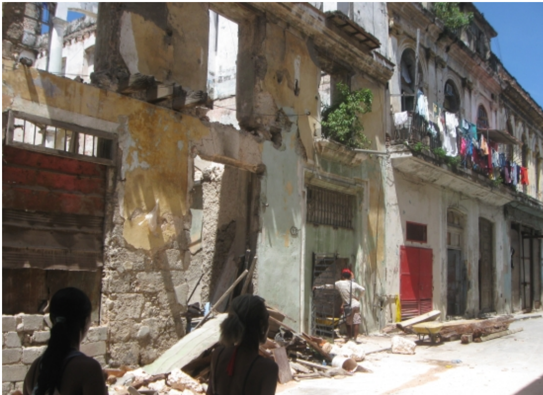
Derrumbe en Centro Habana (Foto: Vicente Morín)
