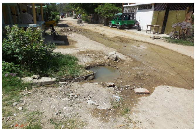
Salidero en la calle 4 Oeste entre Jesús
