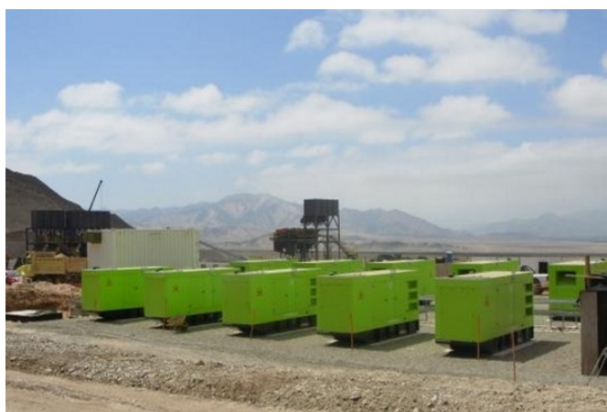
Generadores eléctricos (foto de internet)
